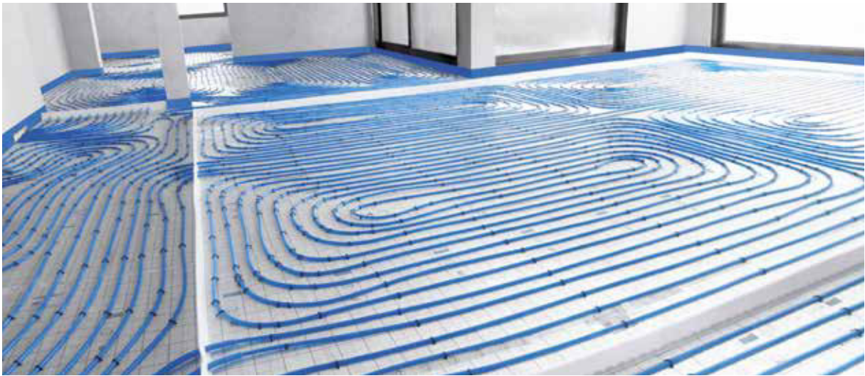
Obr. 25. Instalace podlahového topení/chlazení provedená v systému KAN-therm Tacker.
